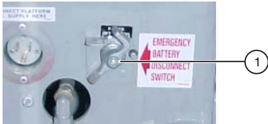
Figura 2-1. Interruptor de desconexión de emergencia de la alimentación principal de energía
